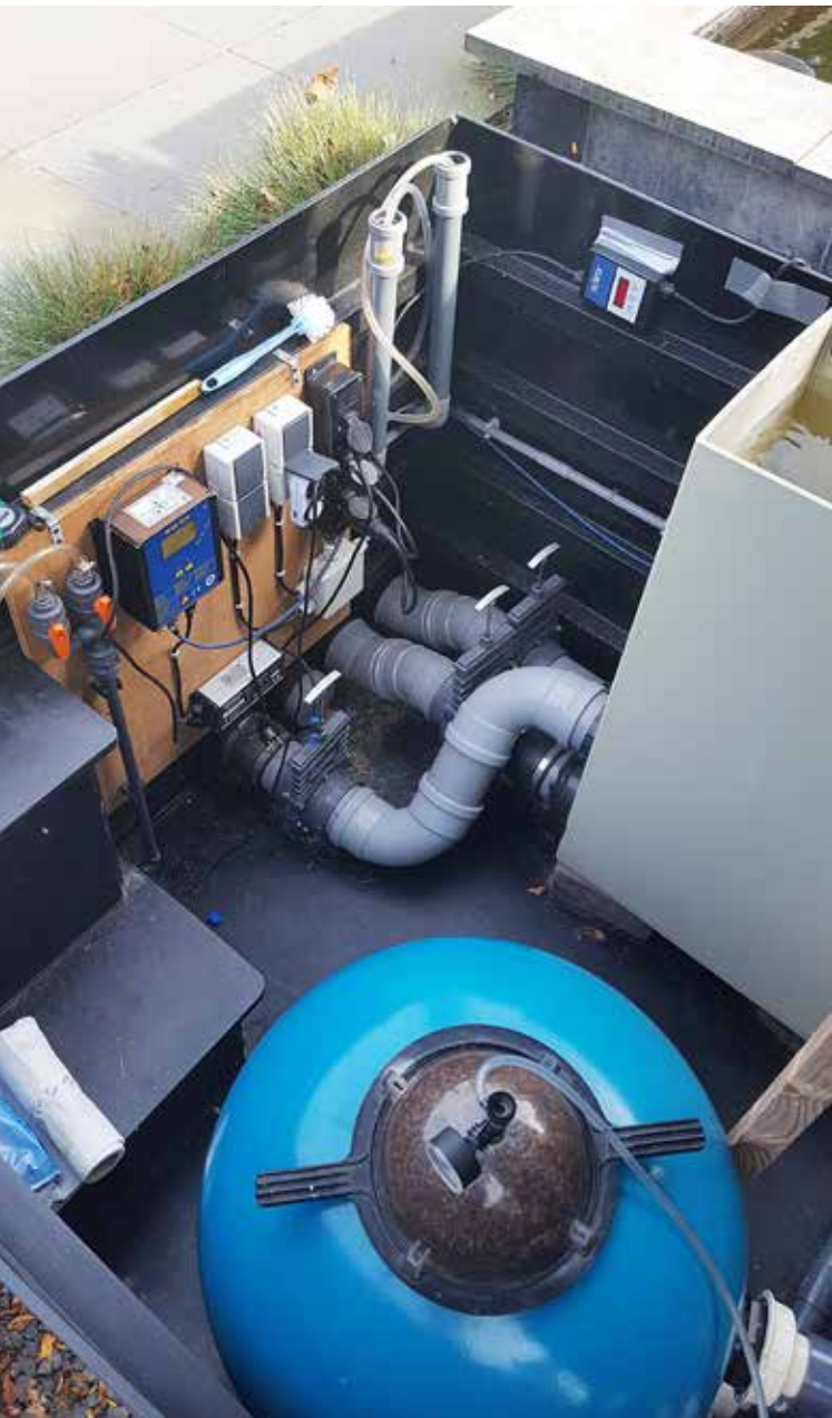
Nette filterkelder met een beadfilter en een sieve.
